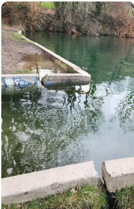
Détail des dégradations sur la structure en bordure du lac Crédit photo : Mairie de Billeu
