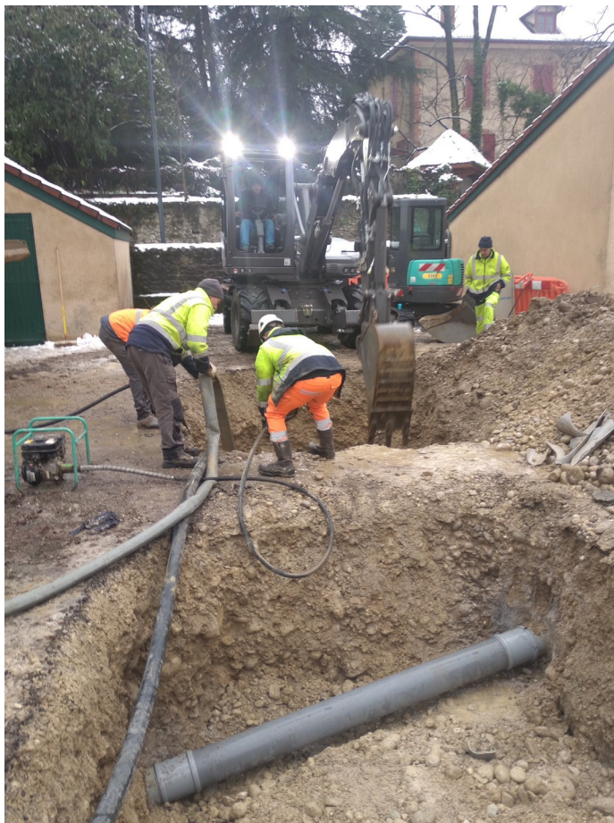
fuite conduite 200 mm rue de Maubec Voiron
